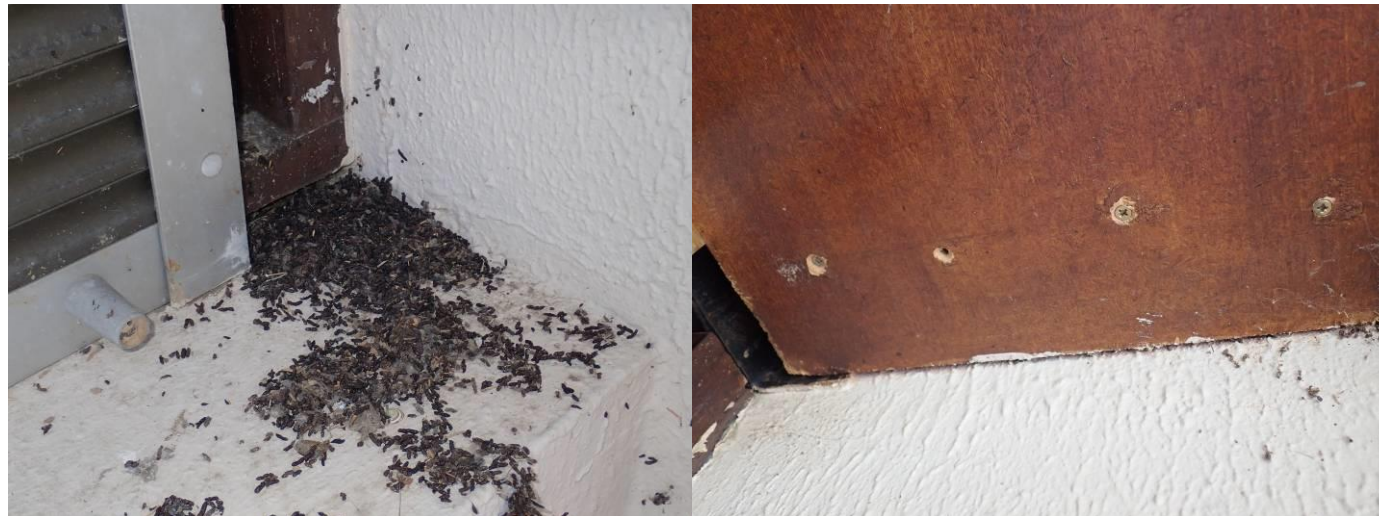
Illustration 7 : Dépôt de guano ancien et bardage réparé à l'aplomb de celui-ci
